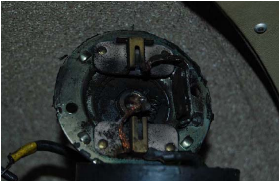
Fig. 6. Elmotorn efter demontering. Foto EMS AB.
